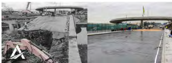
Rys. Infrastruktura drogowa: zniszczenie odbudowa
