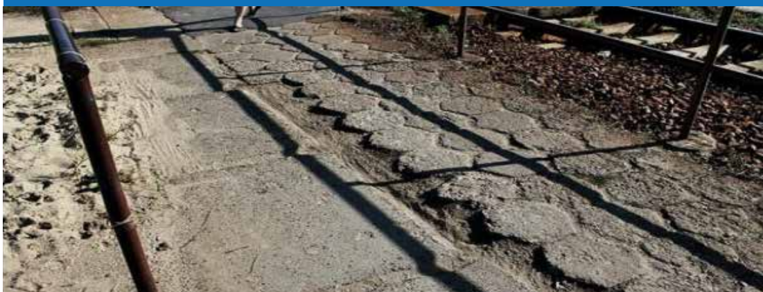
Rys. 2.35. Zła nawierzchnia drogi dojścia do przejścia w poziomie szyn
