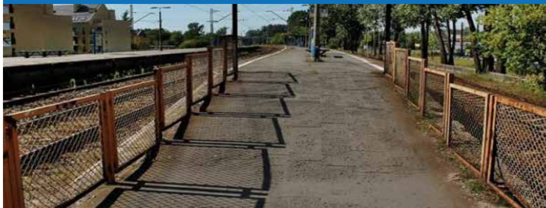
Rys. 2.36. Pochylnia na peron o złym stanie nawierzchni i z brakiem poręczy (Warszawa Gocławek)
