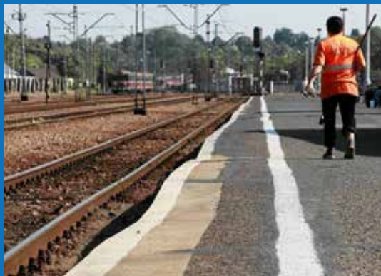
f) Uszkodzona konstrukcja peronu
