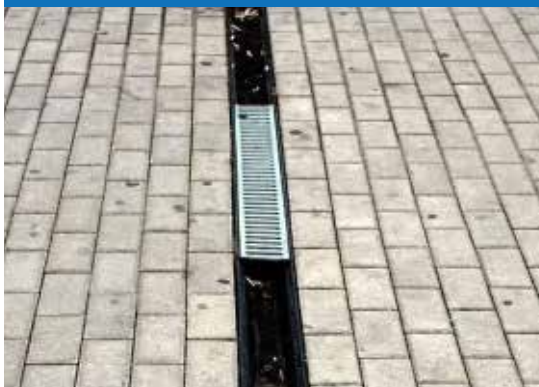
a) Ukradzione elementy odwodnienia
