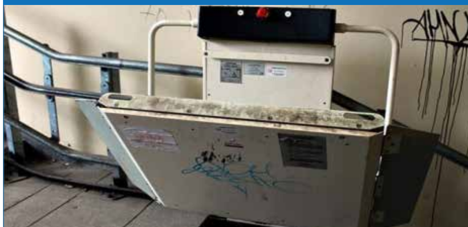
Rys. 2.39. Niesprawny platformowy podnośnik przyschodowy, częściowo rozłożony, stanowiący zagrożenie dla osób korzystających ze schodów
