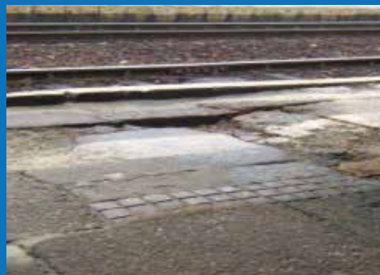
d) Zniszczona nawierzchnia
