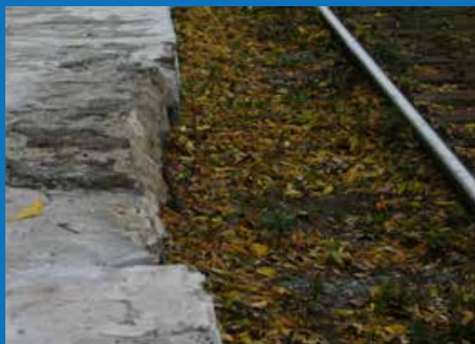
b) Uszkodzona krawędź peronu
