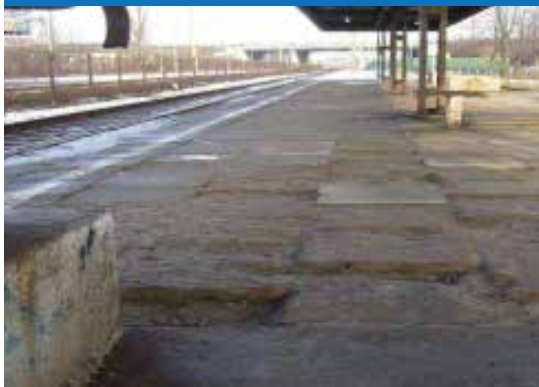
e) Zniszczona nawierzchnia
