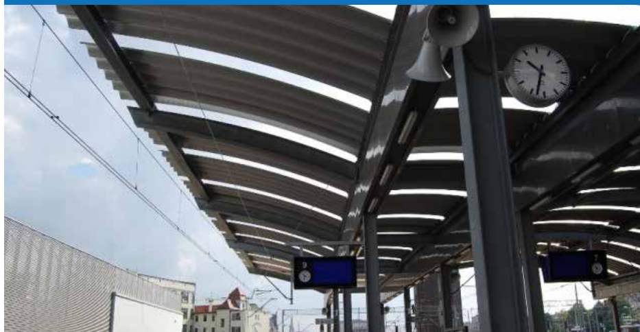
Rys. 2.69. Stacja Katowice. Na zmodernizowanym peronie zainstalowano m.in. megafony (Źródło: Rynek Kolejowy)
