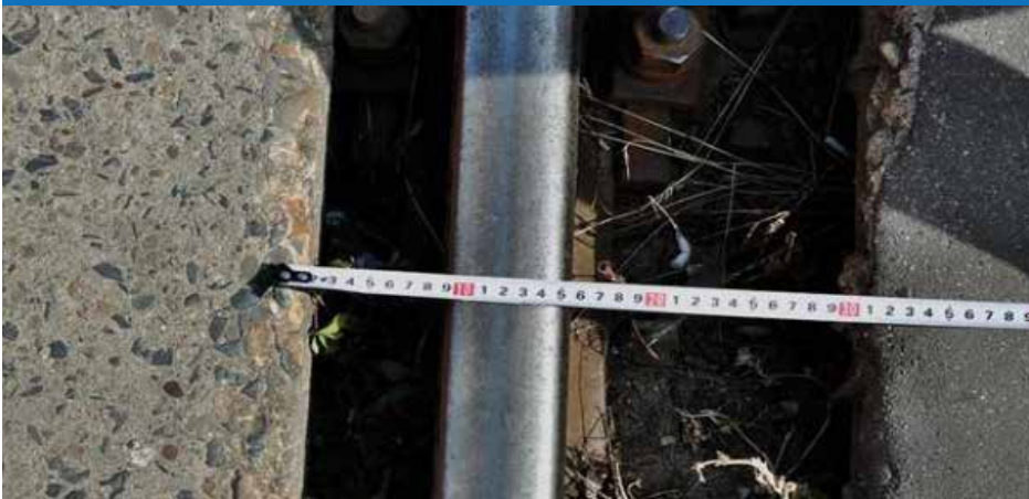
Rys. 2.34. Przykład złego stanu technicznego płyt przejazdowych stanowiących zagrożenie dla osób niepełnosprawnych
